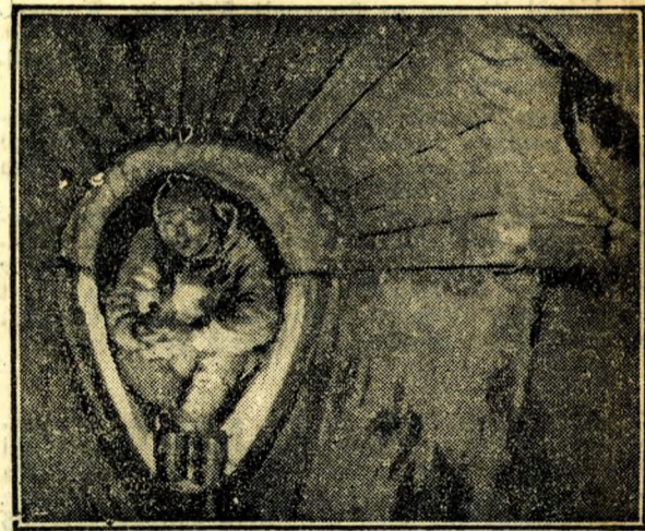
Tojásalakú betőncsatornához érkezik el a bűvár. Jobbra fenn látható, hogyan torkollik be a csatornába egy ház gondatlanul vezetett csőcsatornája.
