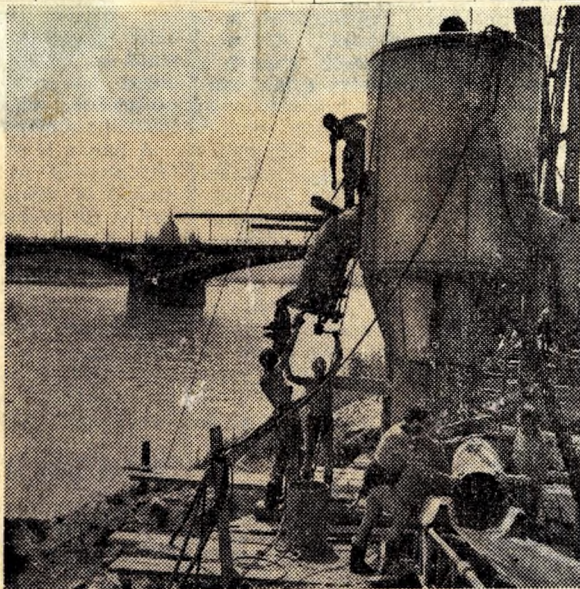
Épül a 3-as számú kút. Bartucz Imre és brigádja a süllyesztés során kikerülő földet az „anyagkiadó-pipán” keresztül küldi a felszínre. A brigád teljesítménye az elmúlt hónapban 170 százalék volt.
