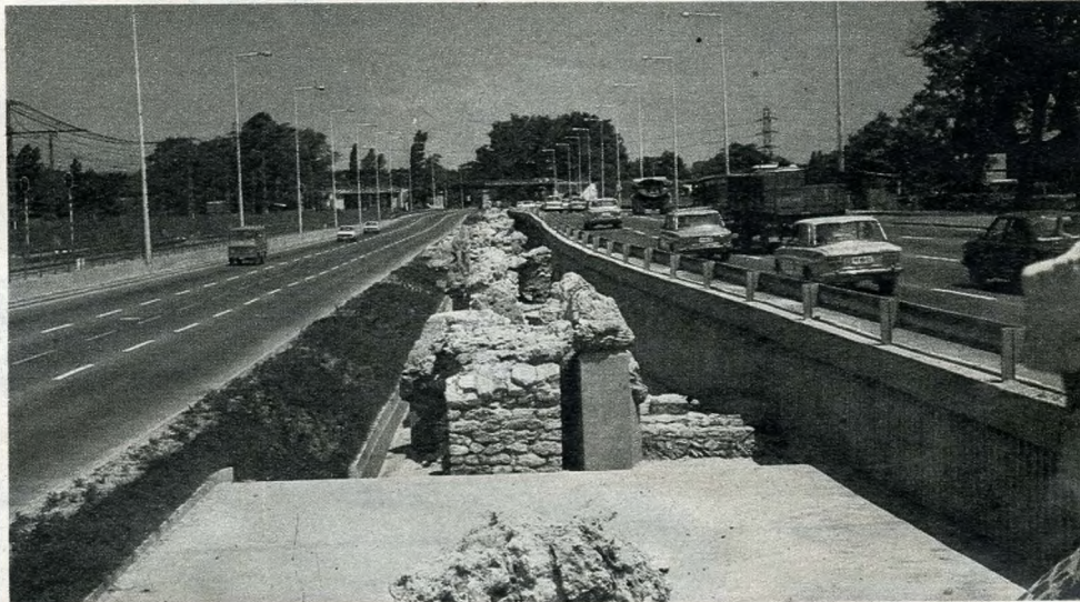
Párját ritkító látványosság a Duna-kanyar vonzási körzetét felkereső autósoknak-motorosoknak: Aquincum nemrégiben helyreállított vízvezeték-maradványa a 11-es út mentén
